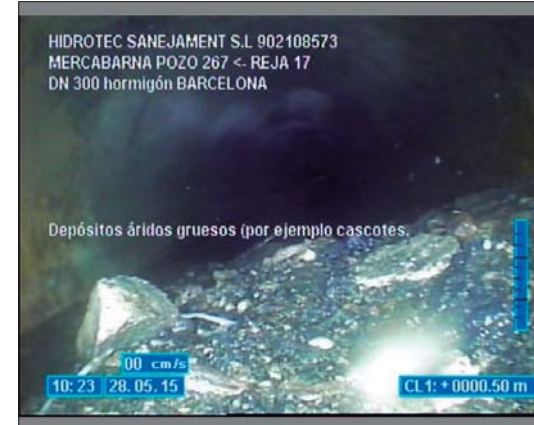
Foto: 28_28_97_A.JPG 0,5m, Depósitos áridos gruesos (por ejemplo cascotes, gravar) en el hilo, grueso Profundidad del depósito: 20 %
