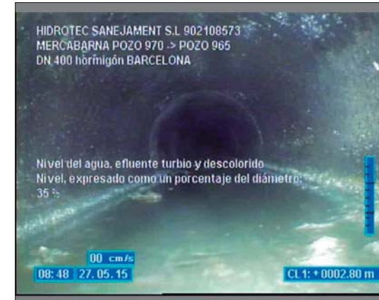
Foto: 5_5_16_A.JPG 2,8m, Nivel del agua, efluente turbio y descolorido Nivel, expresado como un porcentaje del diámetro: 35 %
