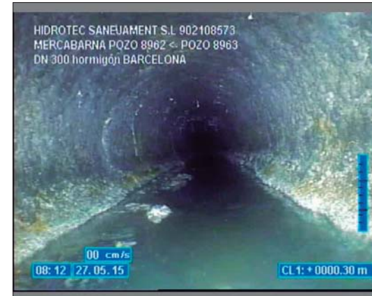
Foto: 1_1_4_A.JPG 0,3m, A través de un defecto se ve el terreno exterior a la tubería
