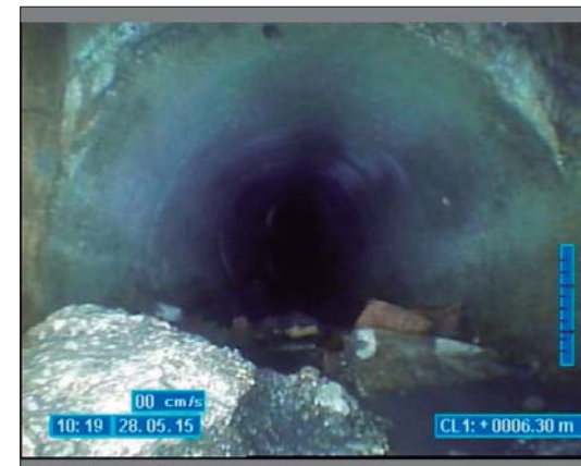
Foto: 27_27_95_A.JPG 6,3m, Material adherido a la pared de la canalización, reducción de la sección transversal Reducción de la sección transversal: 30 %, desde 4 a 8 h.
