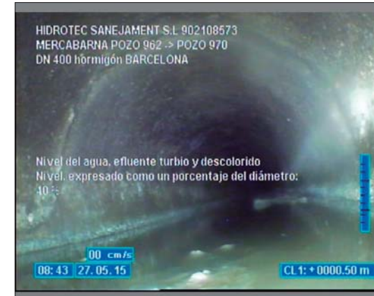
Foto: 3_3_13_A.JPG 0,5m, Nivel del agua, efluente turbio y descolorido Nivel, expresado como un porcentaje del diámetro: 40 %
