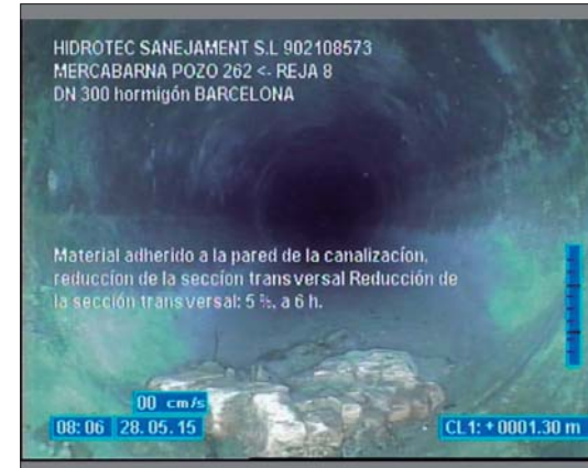
Foto: 17_17_61_A.JPG 1,3m, Material adherido a la pared de la canalización, reducción de la sección transversal Reducción de la sección transversal: 5 %, a 6 h.
