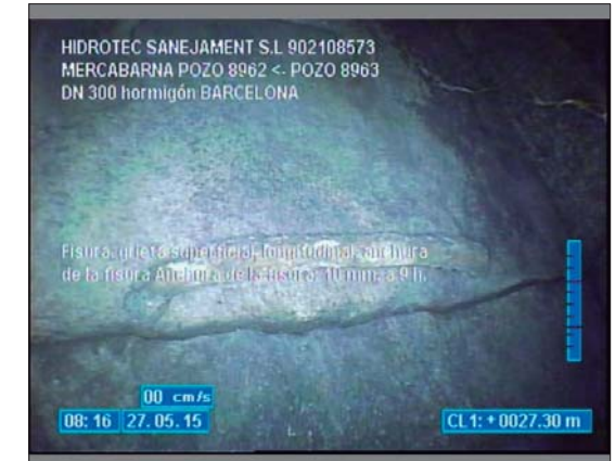
Foto: 1_1_5_A.JPG 27,3m, Fisura, grieta superficial, longitudinal, anchura de la fisura Anchura de la fisura: 10 mm, a 9 h.
