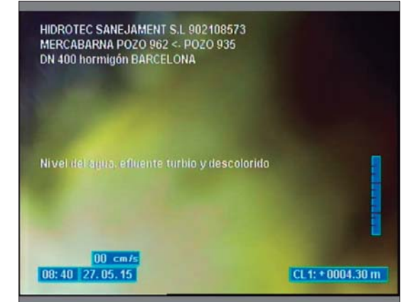
Foto: 2_2_11_A.JPG 4,3m, Nivel del agua, efluente turbio y descolorido Nivel, expresado como un porcentaje del diámetro: 35 %
