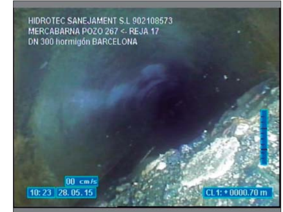
Foto: 28_28_98_A.JPG 0,7m, Inspección abandonada, obstrucción, Todo la conducción
