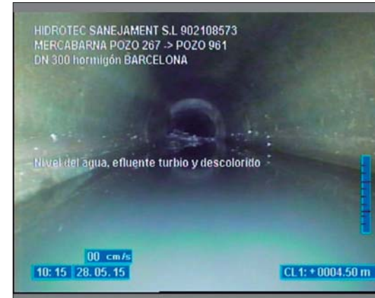
Foto: 27_27_93_A.JPG 4,5m, Nivel del agua, efluente turbio y descolorido Nivel, expresado como un porcentaje del diámetro: 15 %
