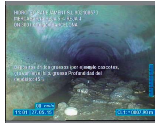
Foto: 13_13_39_A.JPG 7,9m, Depósitos áridos gruesos (por ejemplo cascotes, gravar) en el hilo, grueso Profundidad del depósito: 45 %
