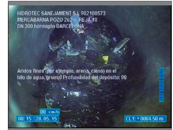
Foto: 20_20_70_A.JPG 4,5m, Aridos finos (por ejemplo, arena, cieno) en el hilo de agua, grueso Profundidad del depósito: 90 %
