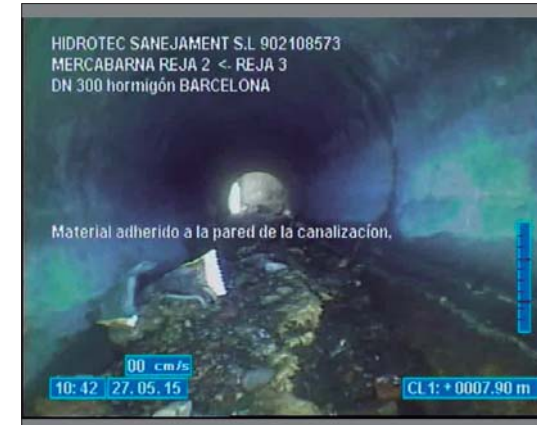
Foto: 12_12_36_A.JPG 7,9m, Material adherido a la pared de la canalización, reducción de la sección transversal Reducción de la sección transversal: 5 %, desde 6 a 8 h.
