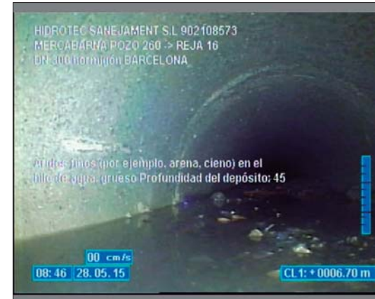
Foto: 23_23_85_A.JPG 6,7m, Aridos finos (por ejemplo, arena, cieno) en el hilo de agua, grueso Profundidad del depósito: 45 %
