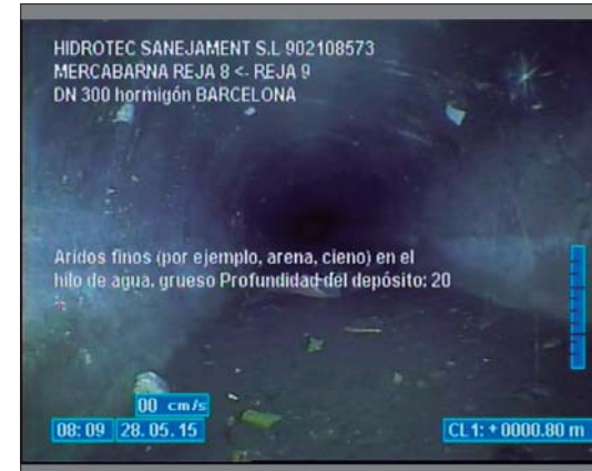
Foto: 18_18_64_A.JPG 0,8m, Aridos finos (por ejemplo, arena, cieno) en el hilo de agua, grueso Profundidad del depósito: 20 %
