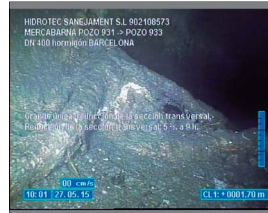
Foto: 7_7_24_A.JPG 1,7m, Grande única, reducción de la sección transversal, Reducción de la sección transversal: 5 %, a 9 h.
