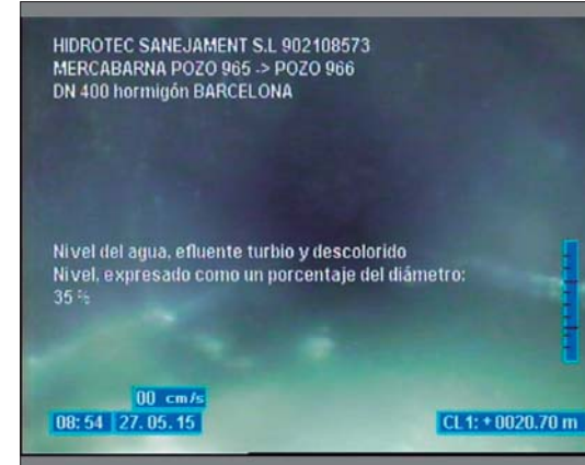
Foto: 6_6_20_A.JPG 20,7m, Nivel del agua, efluente turbio y descolorido Nivel, expresado como un porcentaje del diámetro: 35 %
