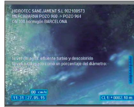
Foto: 9_9_44_A.JPG 2,1m, Nivel del agua, efluente turbio y descolorido Nivel, expresado como un porcentaje del diámetro: 30 %
