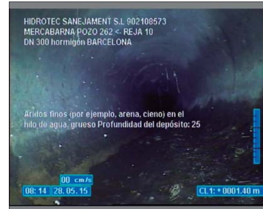
Foto: 20_20_69_A.JPG 1,4m, Aridos finos (por ejemplo, arena, cieno) en el hilo de agua, grueso Profundidad del depósito: 25 %
