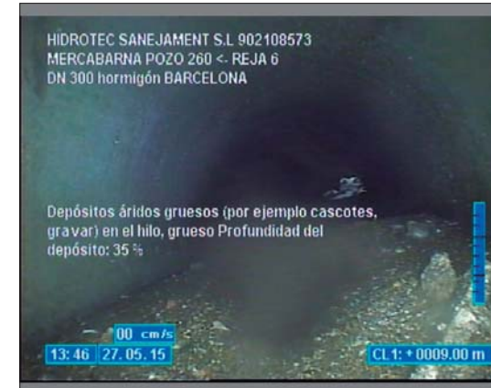
Foto: 16_16_58_A.JPG 9m, Depósitos áridos gruesos (por ejemplo cascotes, gravar) en el hilo, grueso Profundidad del depósito: 35 %
