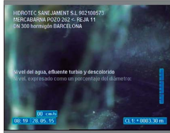
Foto: 21_21_74_A.JPG 3,3m, Nivel del agua, efluente turbio y descolorido Nivel, expresado como un porcentaje del diámetro: 15 %
